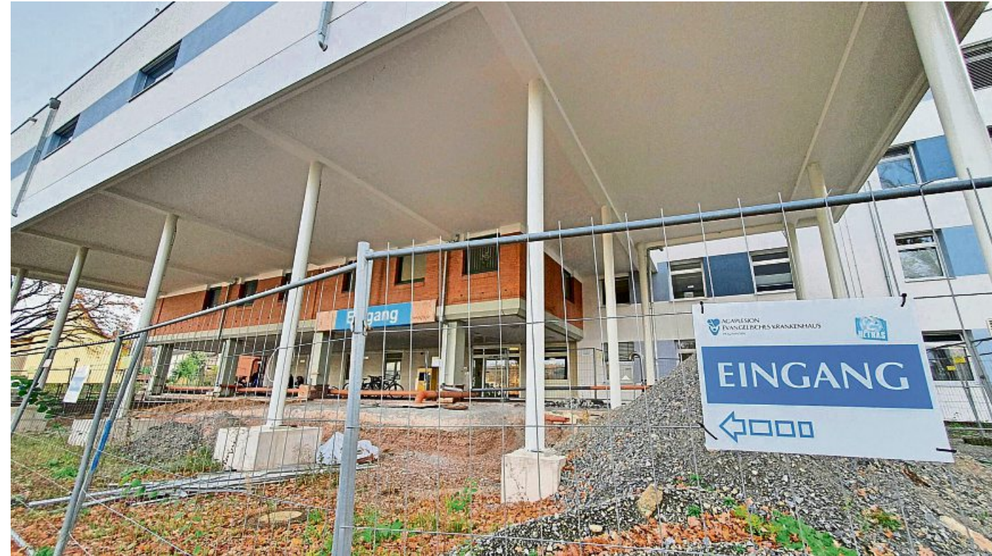
Baustelle Krankenhaus Holzminden: Seit langer Zeit sieht es im unfertigen Eingangsbereich so aus.
